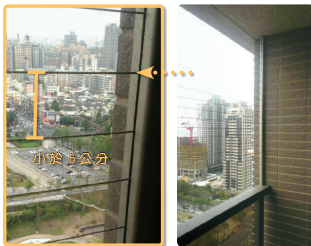
▲ 防墜圍籬、柵欄，間隔（縫）小於 6 公分
