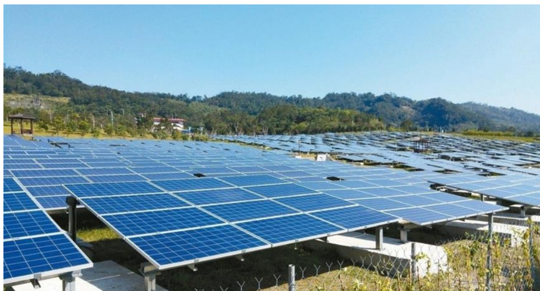
圖 1 能源之丘太陽光電面板照片一
